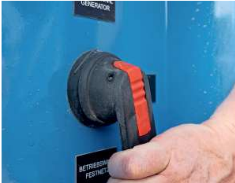
Einfach umschalten: vom Generator auf Netzbetrieb.
