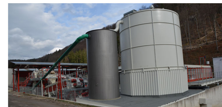
Prozesswassertank und Klärturn / Process water tank and clarification tower / Récipient de l'eau de process et tour de décantation
